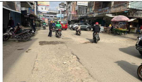
Gambar (10) Kondisi Jalan Rustam Effendi
