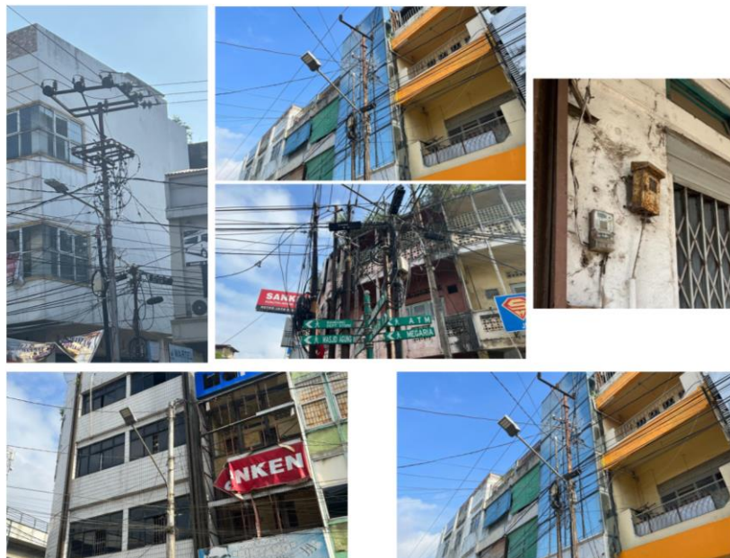
Gambar 4-7 Kondisi Jaringan Listrik dan Telekomunikasi
